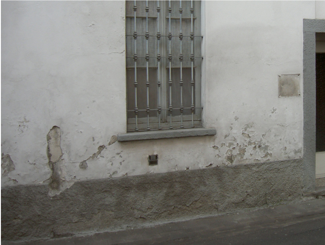
Danni causati dall'umidità di risalita: effetto bagnato, distacco della tinteggiatura e della stabilitura.
