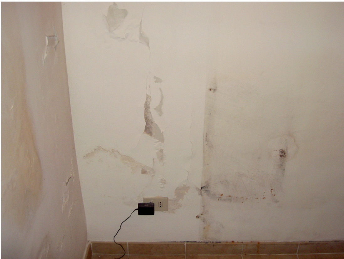
Danni causati dall'umidità di risalita: ingiallimento dell'imbiancatura, distacco dell'imbiancatura e della stabilitura, formazione di muffe.
