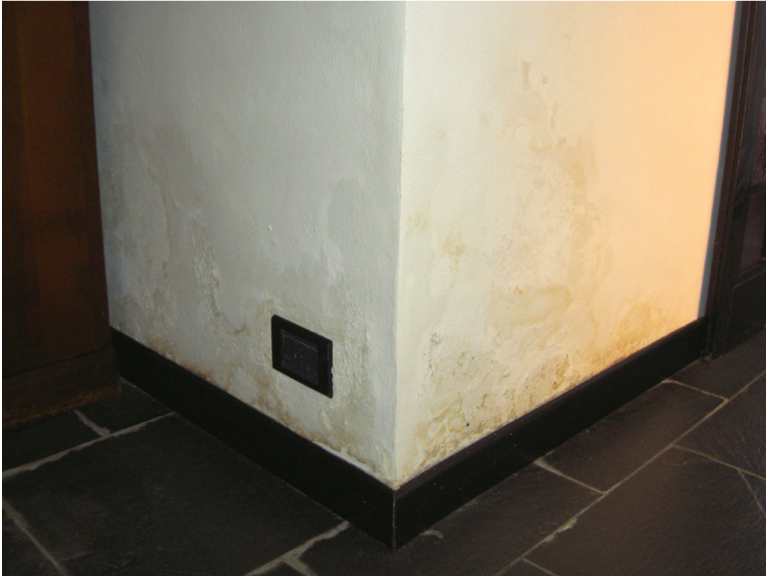
Danni causati dall'umidità di risalita: ingiallimento dell'imbiancatura, distacco dell'imbiancatura e della stabilitura.
