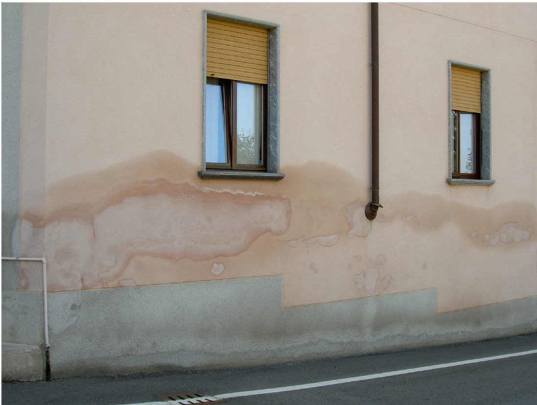
Danni causati dall'umidità di risalita: effetto bagnato marcato ed efflorescenze saline.
