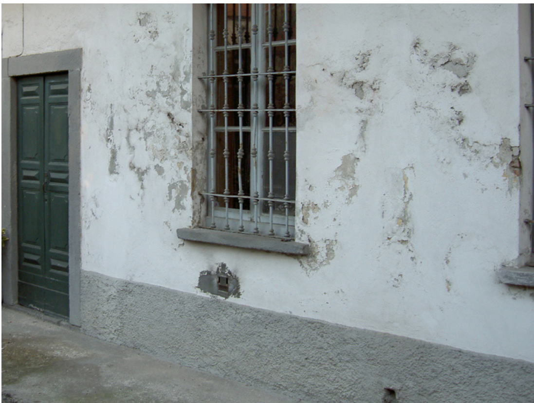
Danni causati dall'umidità di risalita: distacco della tinteggiatura e della stabilitura.
