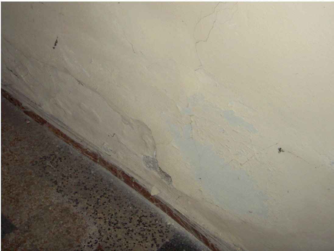
Danni causati dall'umidità di risalita: effetto bagnato, distacco dell'imbiancatura e della stabilitura.
