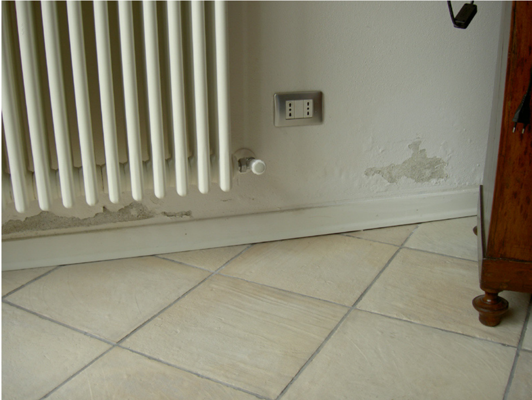
Danni causati dall'umidità di risalita: distacco dell'imbiancatura e della stabilitura.
