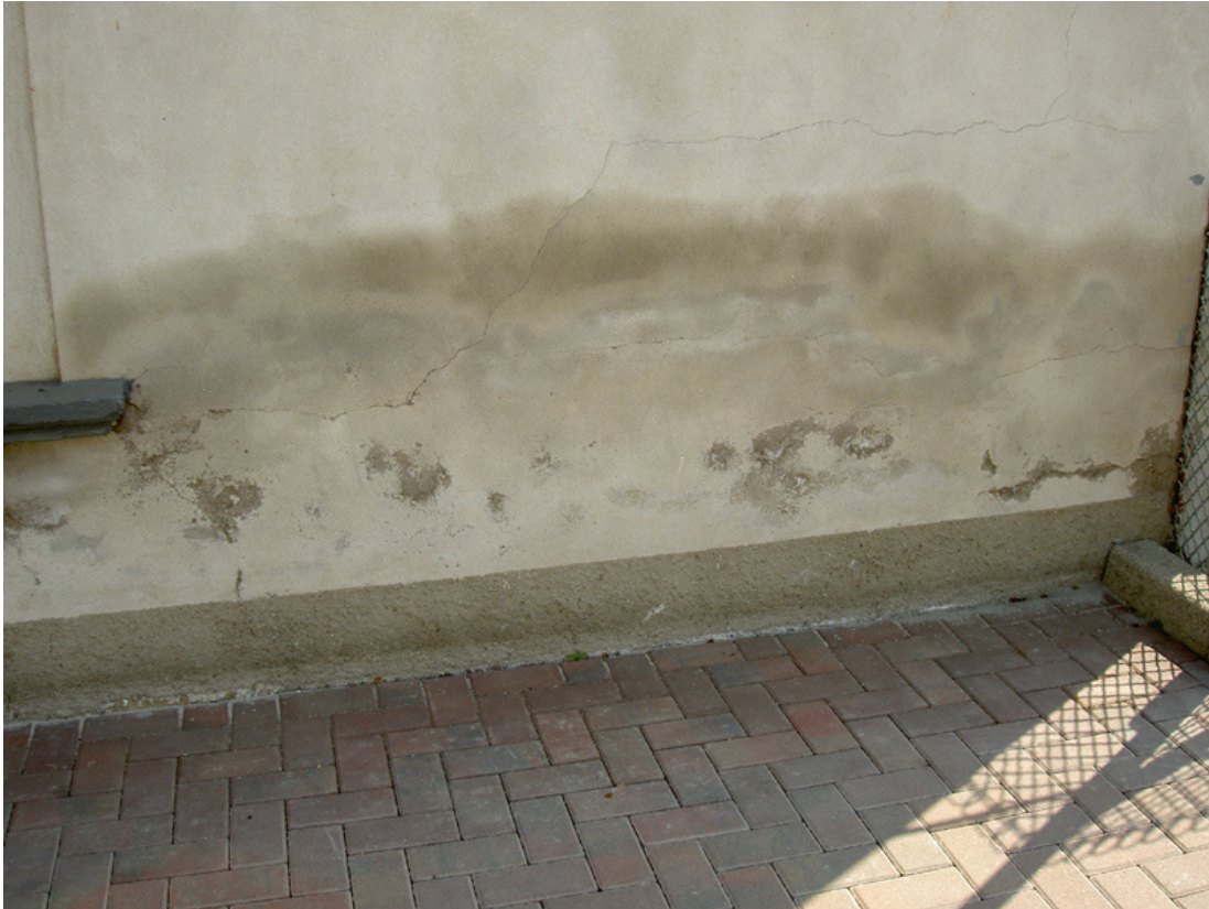
Danni causati dall'umidità di risalita: effetto bagnato marcato, distacco della tinteggiatura e della stabilitura.
