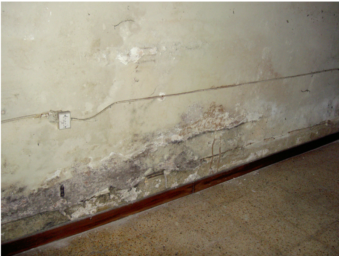
Danni causati dall'umidità di risalita: distacco dell'imbiancatura, della stabilitura e dell'intonaco, e formazione di muffe.
